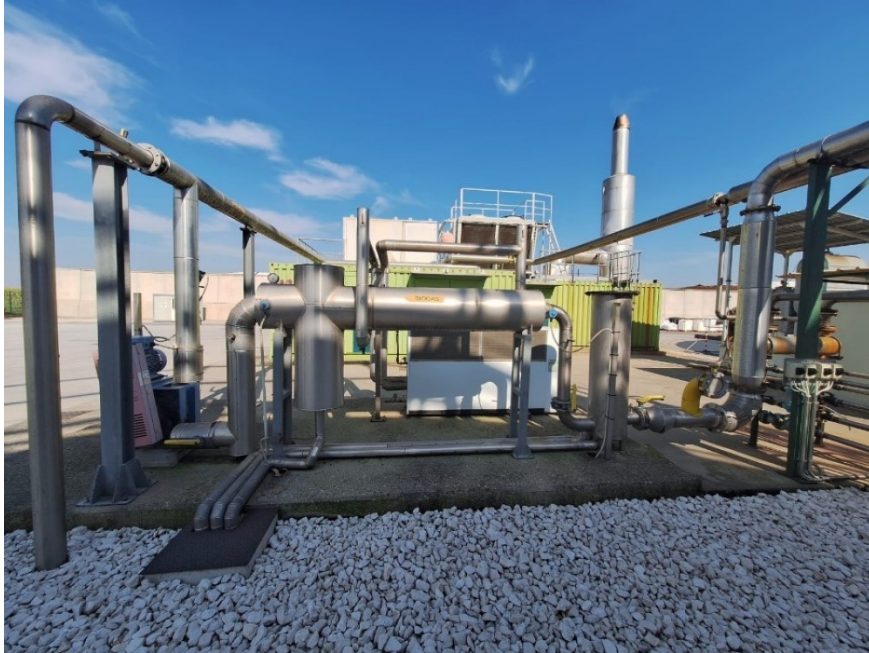
Figura 4 Impianto di cogenerazione
