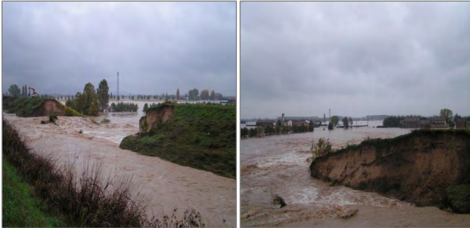
Fig. 5.6: Rottura dell'argine destro del fiume Frassine nel 2010
