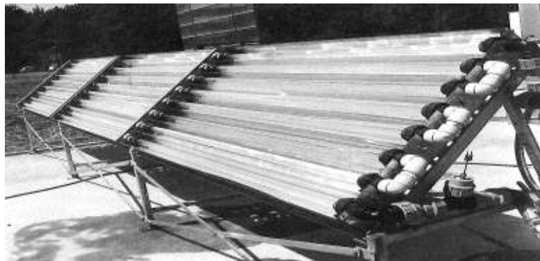
Figura 3.12 Batteria di collettori parabolici
