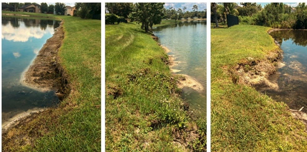
Figura 25: serie di immagini che da sinistra a destra, mostrano un esempio di scalzamento del piede di una sponda (Dragonflypondworks.com)
