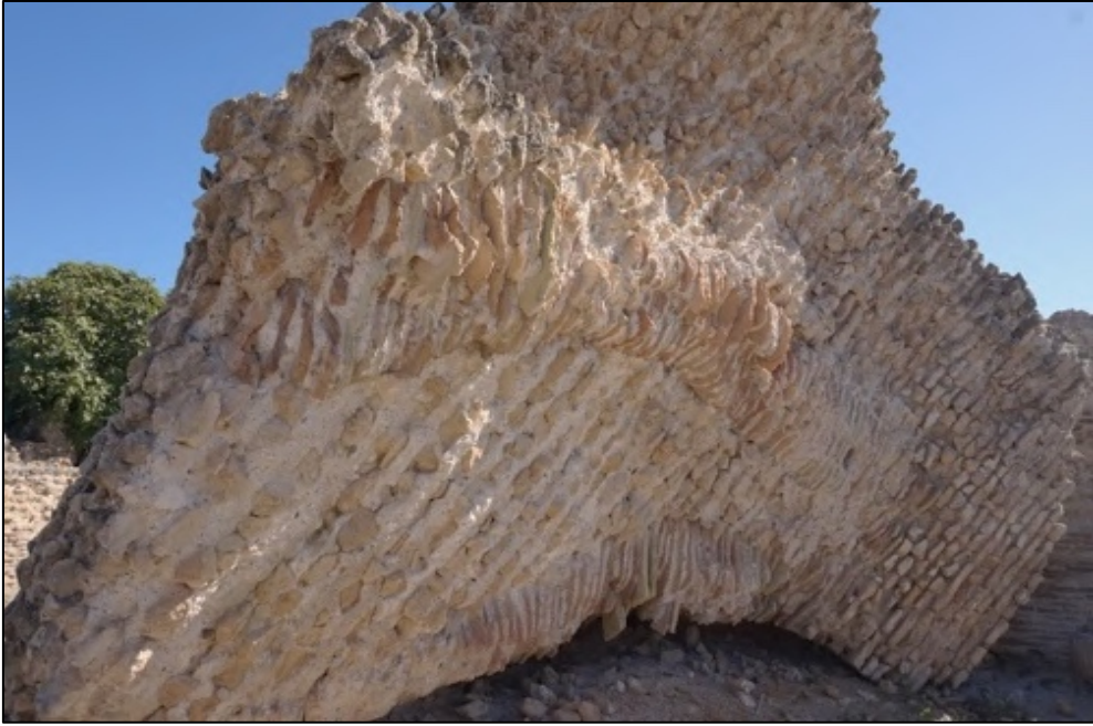
Fig. 3.2.3. Volta a crociera in stato di collasso nell'atrio principale (vano B).
