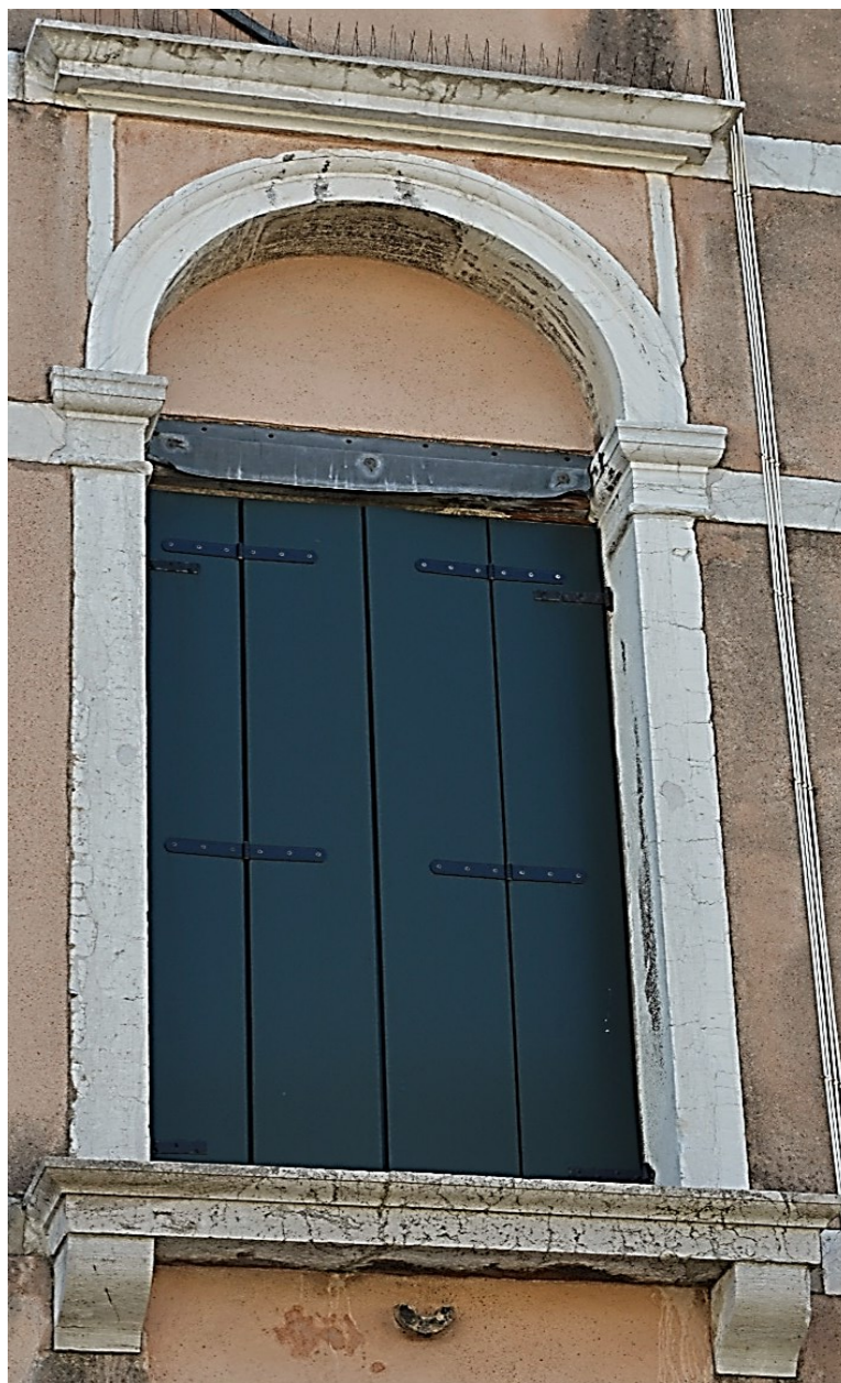
Fig. 20 Dettaglio di una monofora del primo e del secondo piano nobile , inscritta all'interno di un arco a tutto sesto a sua volta inquadrato da due sottili lesene che dal piano d'imposta dell'arco si sviluppano fino alla cornice modanata, collocata poco più sopra dell'arco; ogni monofora è dotata di davanzale modanato sorretto da due semplici mensole aggettanti. Foto dell'autrice.
