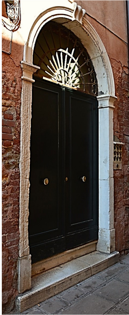
Fig. 32 Dettaglio del portale d'accesso principale via terra da calle degli Ormesini. Foto dell'autrice.
