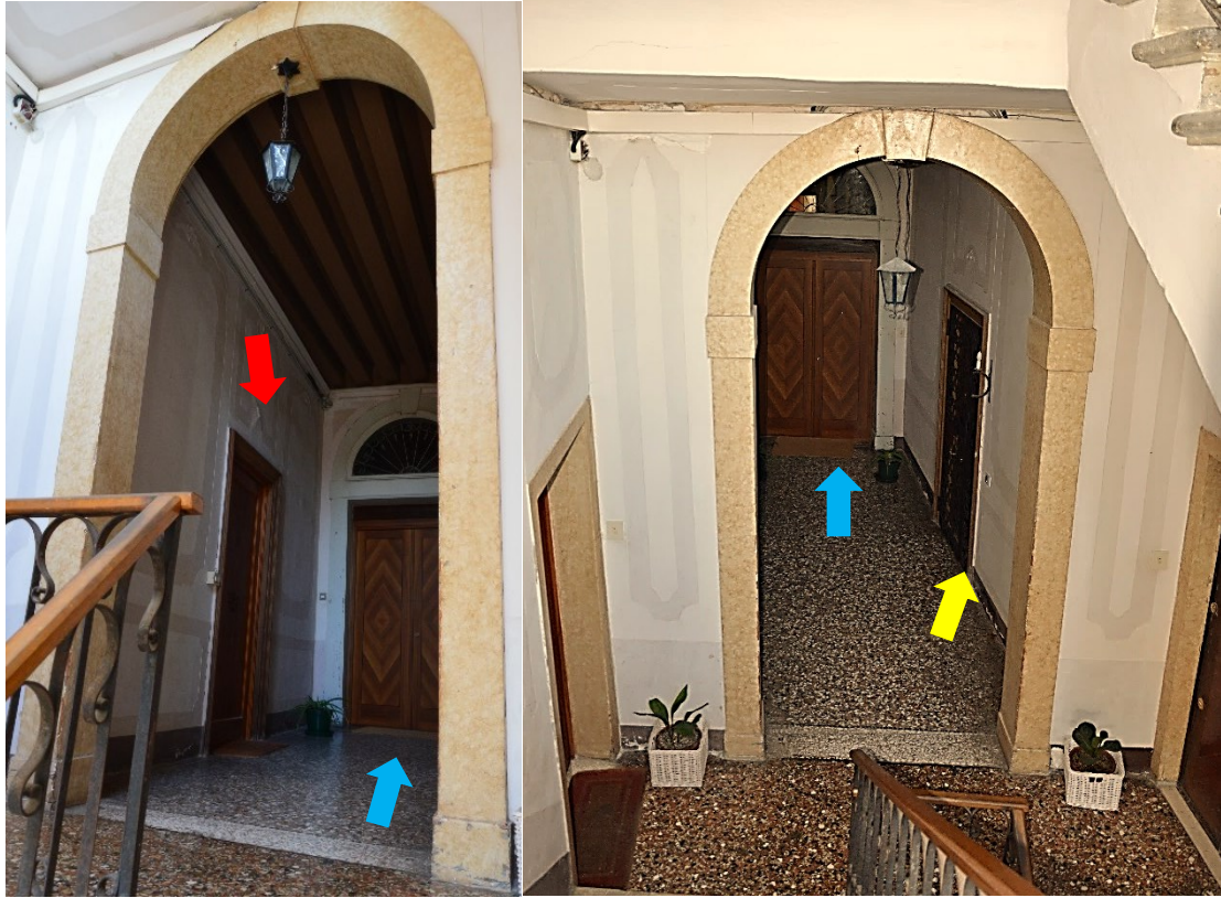
Fig. 36 Dettaglio del «portego» del secondo piano nobile adibito a pianerottolo, a seguito del suo frazionamento. Dalla facciata principale il «portego» in questione è quello dotato con affaccio a trifora e poggiolo posto nel registro del secondo piano nobile, tutto a sinistra. Nell'immagine di sinistra si vede l'ingresso dell'appartamento caratterizzato da metà «portego» con affaccio a trifora in calle del Porton (freccia rossa), mentre nell'immagine di destra si può notare l'ingresso dell'appartamento caratterizzato dall'altra metà del «portego» con affaccio a trifora e poggiolo prospiciente il rio di San Girolamo (freccia gialla). La porta evidenziata con le frecce azzurre permette, invece, l'accesso all'appartamento nell'estremità destra del secondo piano nobile. Quindi in totale al secondo piano nobile si distribuiscono tre unità abitative. Foto dell'autrice.
