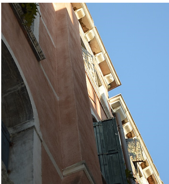
Fig. 31 Dettaglio del cornicione discontinuo da calle del Porton. Foto dell'autrice.
