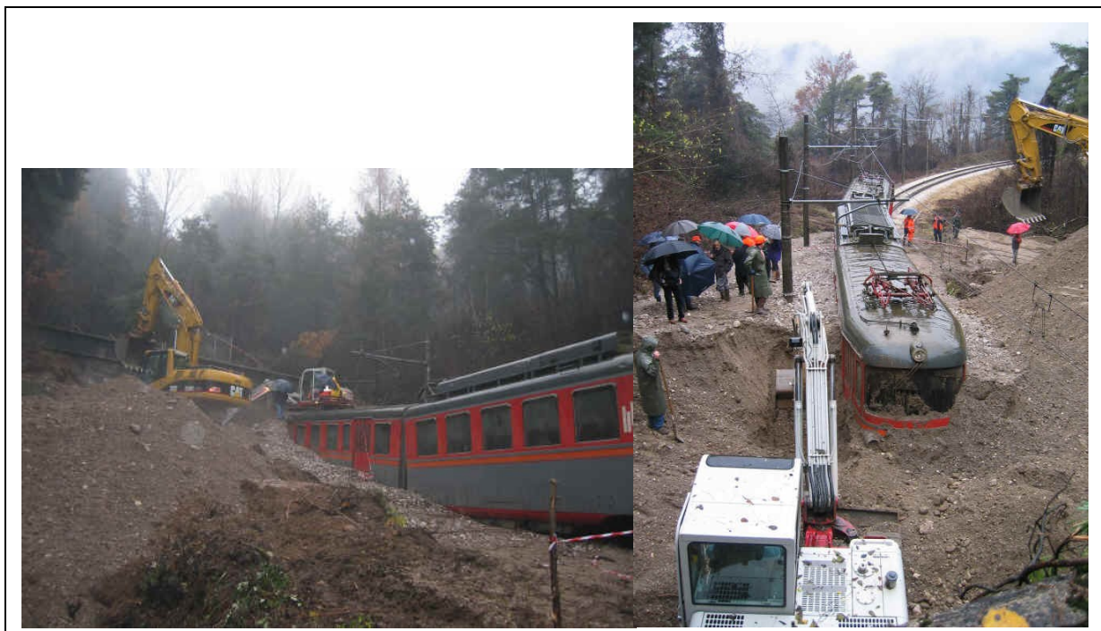
Figura 1.7: Il giorno 27/11/2003 alle ore 20.30 circa si è verificata una frana in seguito a persistenti precipitazioni, in località Mollaro nel Comune di Taio (TN) che ha coinvolto la linea ferroviaria Trento-Malè.
