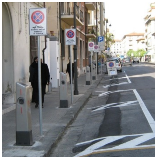
(b) Colonnine per la ricarica installate a Pisa da ENEL
