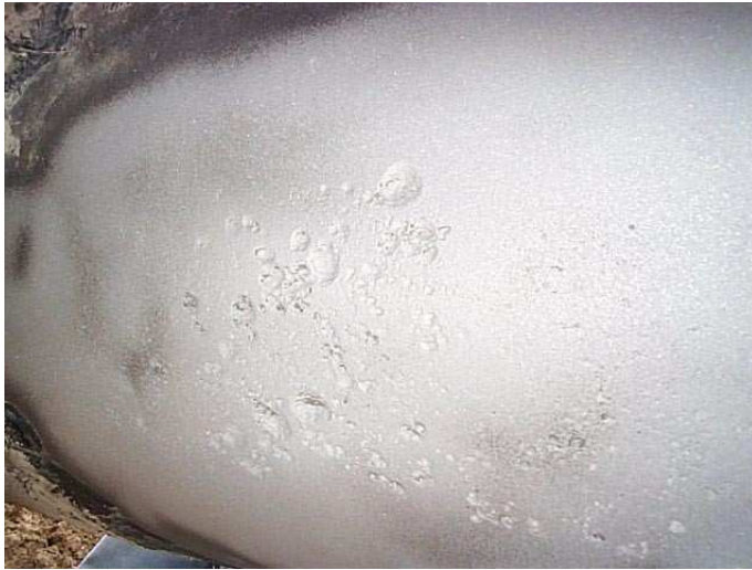
Fig.2.1 condotta interessata da corrosione, superficie ripulita con sabbiatura
