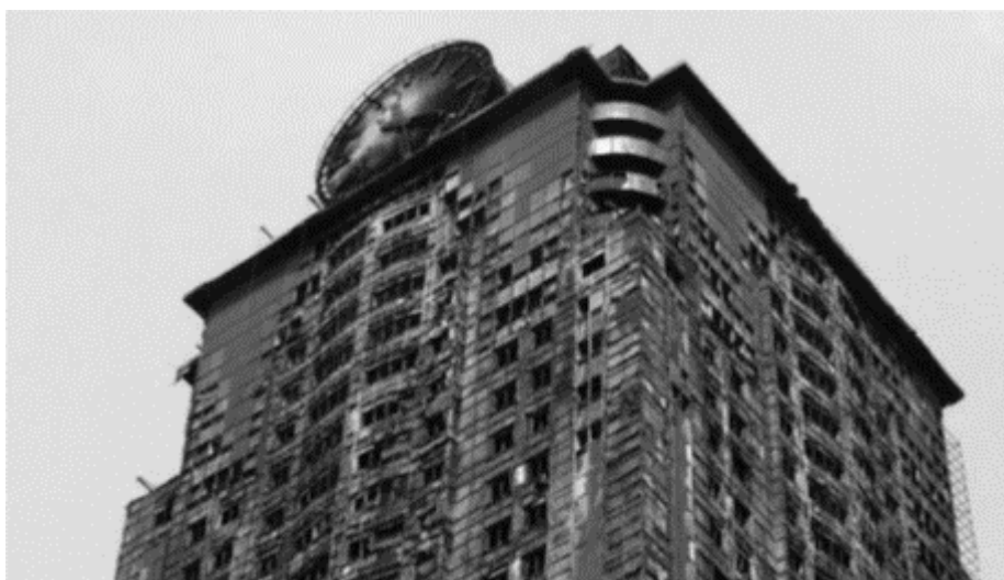
Figura 4.6. Resti della facciata esterna interessata dall'incendio
