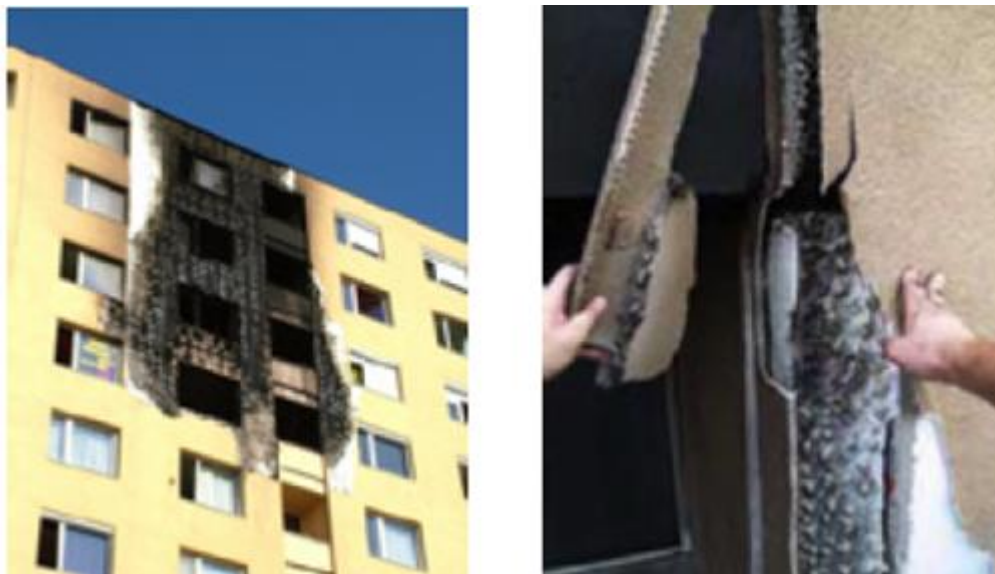
Figura 4.10. Conseguenze dell'incendio sulla facciata dell'edificio di abitazione civile a Miskolc
