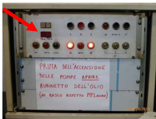
Fig. C.14: Pannello di controllo delle pompe idrauliche.
