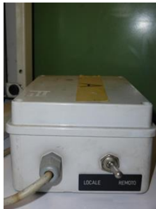
Fig. C.4: Commutatore controllo Locale/Remoto.
