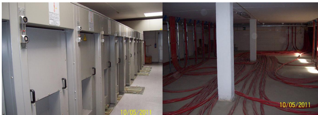
Fig. 13 - Armadi di partenza delle linee e uscita dei cavi da sotto gli armadi
