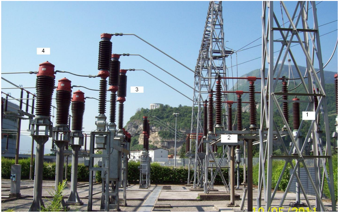
Fig. 11 - Ingresso cabina primaria
