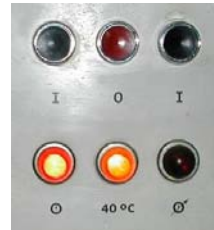
Figura 2.6.1e Accensione pompa ausiliari
