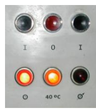
figura 5.3.1e Accensione pompa ausiliari
