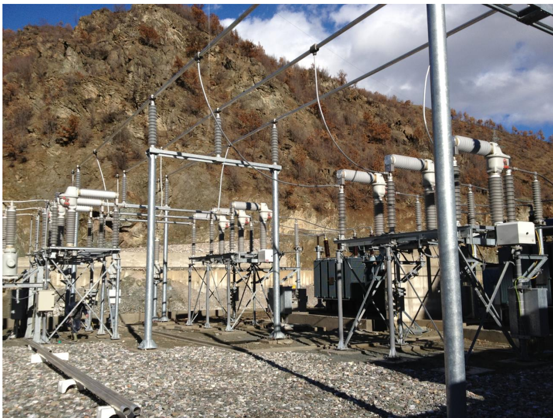
Figura 7.1 Foto delle sbarre e dei conduttori flessibili nella sottostazione in esame
