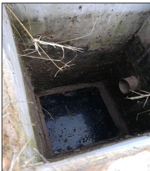
Figura 7: Pozzo localizzato all'interno della base con evidenze visive e olfattive della presenza di contaminante.
