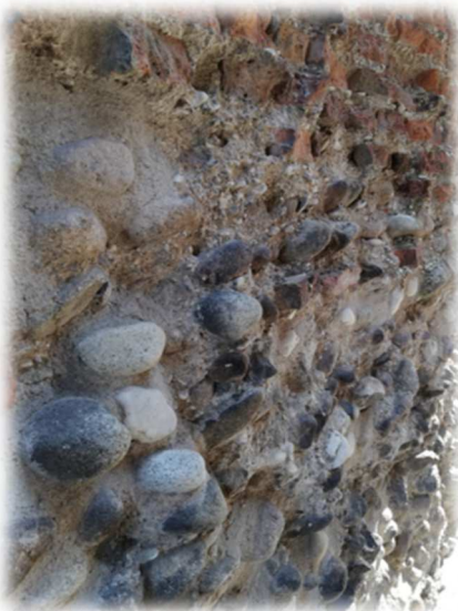
Fig.63 Particolare di parti erose delle mura, Cittadella, PD.
