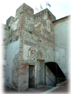
Fig. 11 Resti di intonaco bianco nelle pareti della Casa del Capitano, Cittadella, PD.
