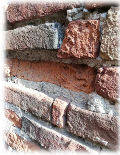
Fig.64 Particolare di distacco di frammenti delle mura, Cittadella, PD.
