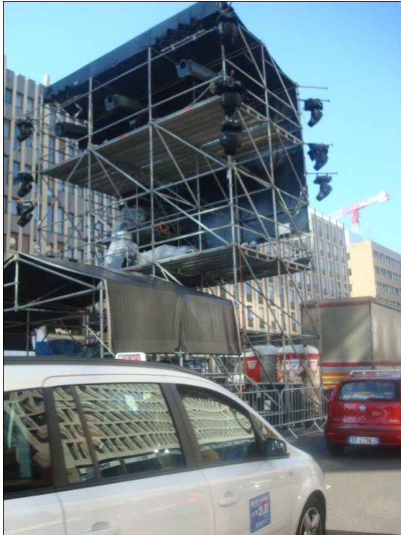
Torre per il posizionamento di proiettori luminosi comandati da operatore
