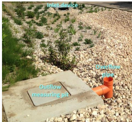
Figura 14: Disposizione dei dispositivi di misurazione in uscita situati nel rain garden di Via dei Prati, (Report terzo anno)
