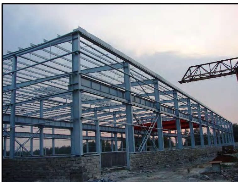
Figura 2: grandi capannoni industriali nei quali i profili formati a freddo trovano spazio nell'orditura secondaria
