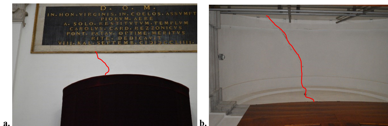
Figura 3.41 - a. Lesione sopra il portale centrale; b. Lesione nell'arco degli ingressi laterali
