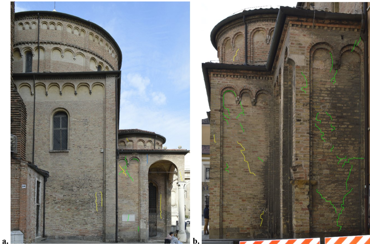
Figura 3.13 - a. Quadro fessurativo prospetto sud Battistero; b. Quadro fessurativo prospetto nord Battistero
