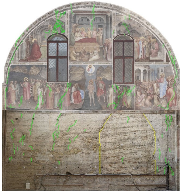
Figura 6.23 - Quadro fessurativo parete sud
