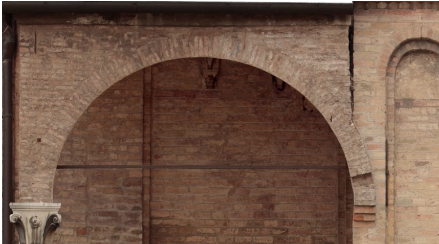
Figura 3.18 – Sconnessione tra la loggia e la parete absidale
