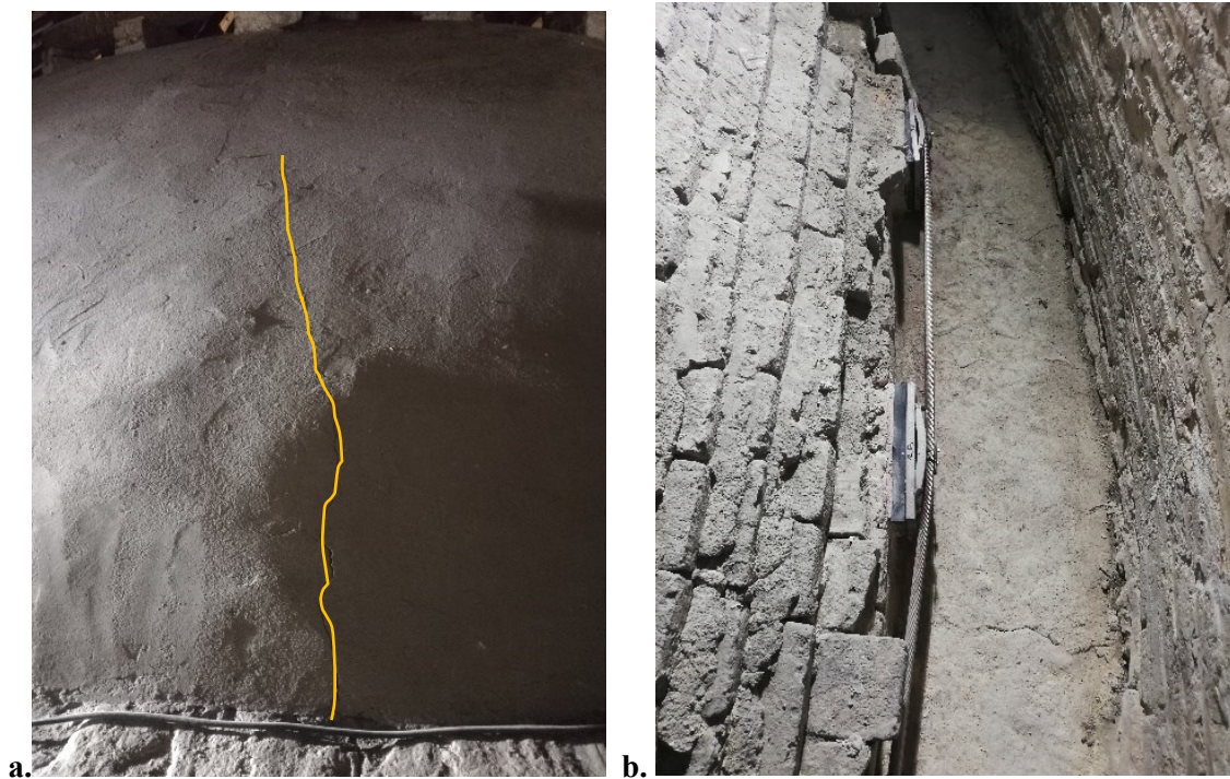
Figura 3.14 - a. Fessurazione all'estradosso della cupola; b. Fessurazione sul camminamento
