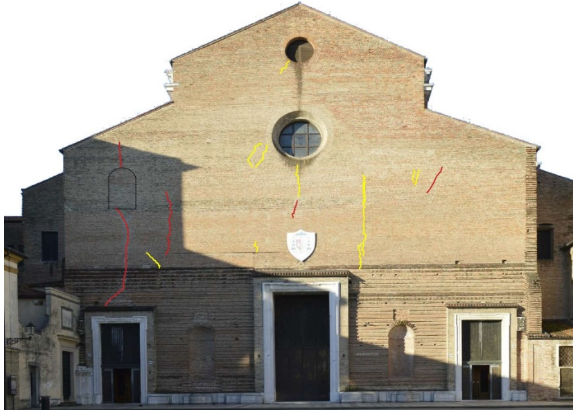
Figura 6.27 - Quadro fessurativo reale prospetto est
