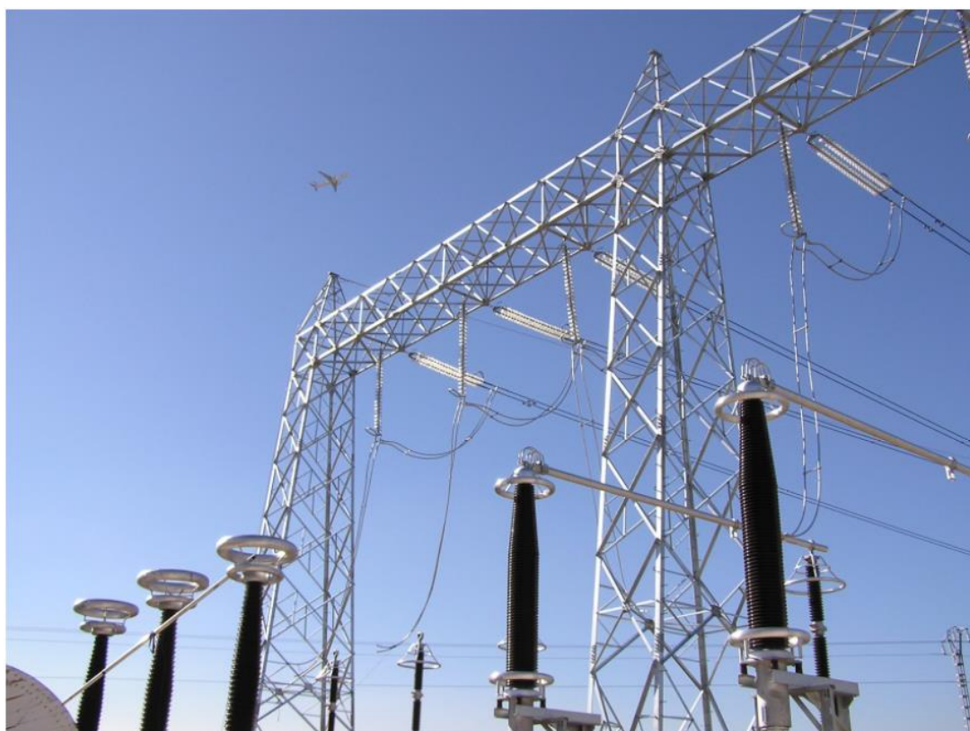
Figura 12 - Sottostazione dove avviene la connessione tra linee aeree e cavi
