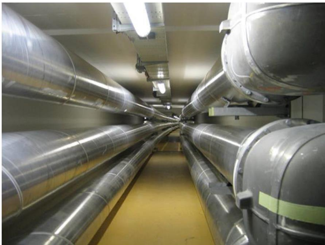
Figura 23 - Foto del tunnel con la doppia terna GIL ultimata
