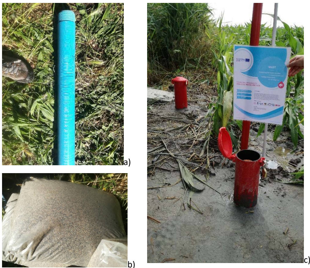
Fig. 2.12: Pozzi-piezometri MoST: Rivestimento in PVC microfessurato (a); ghiaia utilizzata per riempire l'intercapedine tra pareti del foro e piezometro (b); Testa dei pozzi piezometrici (c).
