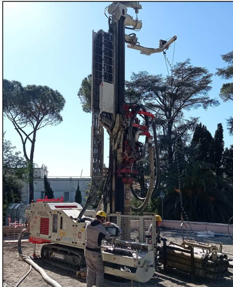
Figura 23. a) Perforatrice idraulica COMACCHIO GEO 700-GT in posizione di trasporto; b) Perforatrice posizionata su punto di perforazione.
