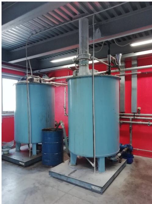
Figura 3.12 – Vista dei serbatoi 2 e 3
