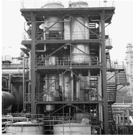
Figura 3.25: Trasformatore di calore con una potenza di 5000 kW
