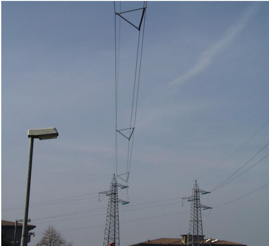
Figura 37: Esempio di linea con compattatori installati
