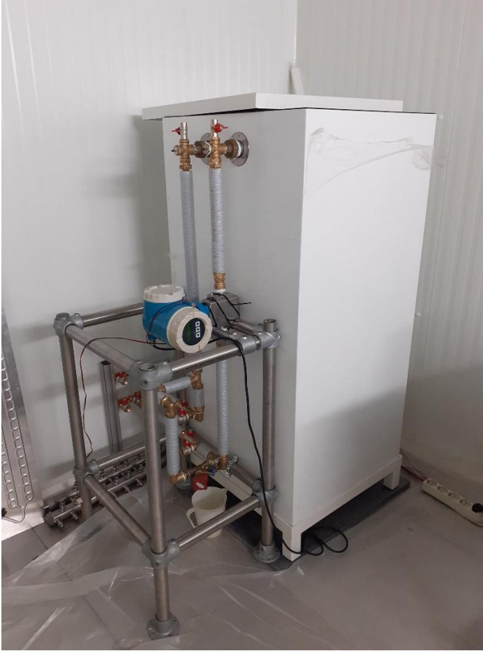
Figura 1. Il container dell'impianto sperimentale.
