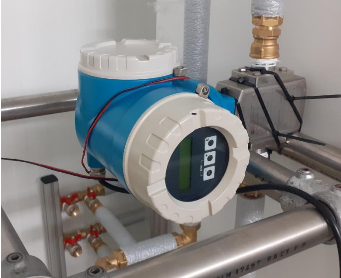
Figura 5. Il misuratore di portata presente nell'impianto.
