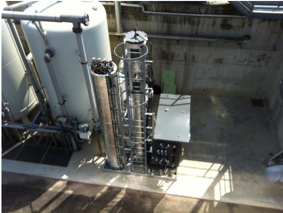
Figura 22. Impianto SHARON-ANAMMOX di Villaganzerla (VI)
