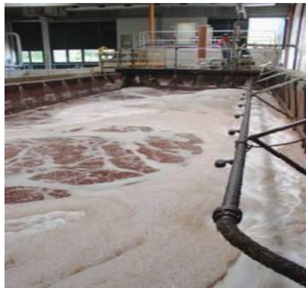
Figura 19. L'impianto DEMON di Strass (Austria)
