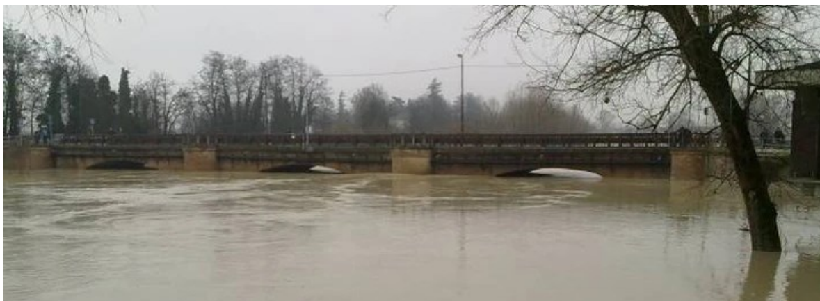
Figura 2.1.1: Esempio di spinta eccessiva sulle pile in periodo di piena. (Riportata in: https://www.ilgiorno.it/mantova/cronaca/fiume-secchia-esondazione-1.707585 ).
