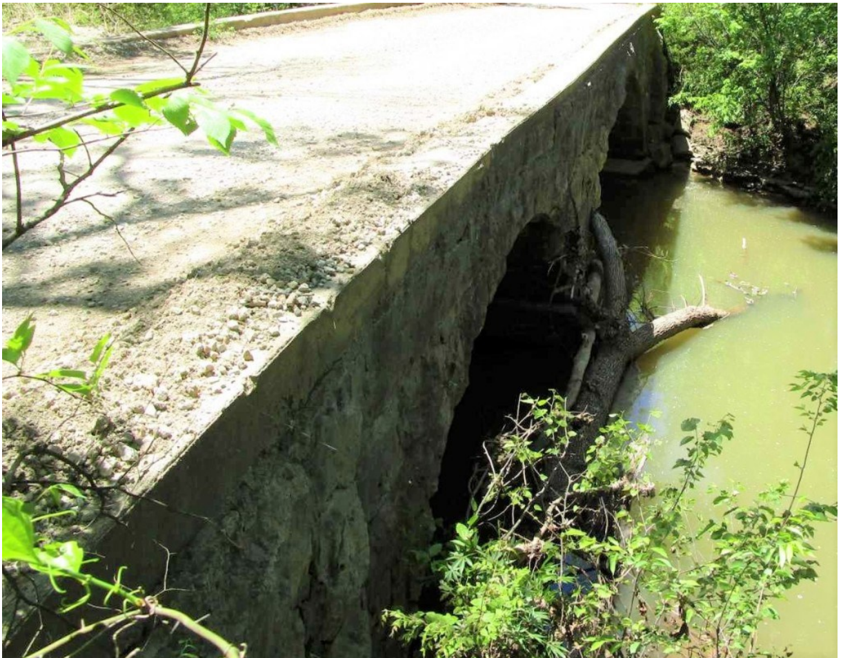
Figura 3.3.1: Esempio di come un ponte senza frangicorrente abbia difficoltà a condurre oltre la struttura ciò che viene trasportato dalla corrente. (Riportata in: https://stonearchbridges.com/2020/04/07/two-benefits-of-cutwaters/ )
