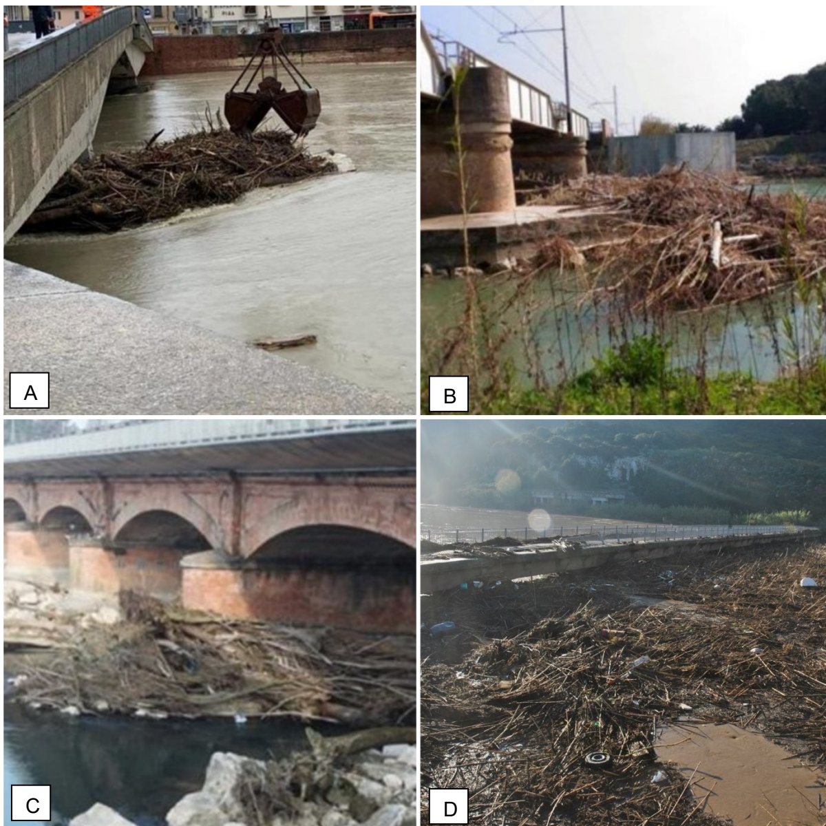
Figura 2.2.2: Esempi di ostruzione parziale delle luci dato dalla vegetazione trasportata dalla corrente e accumulata in prossimità delle pile.
