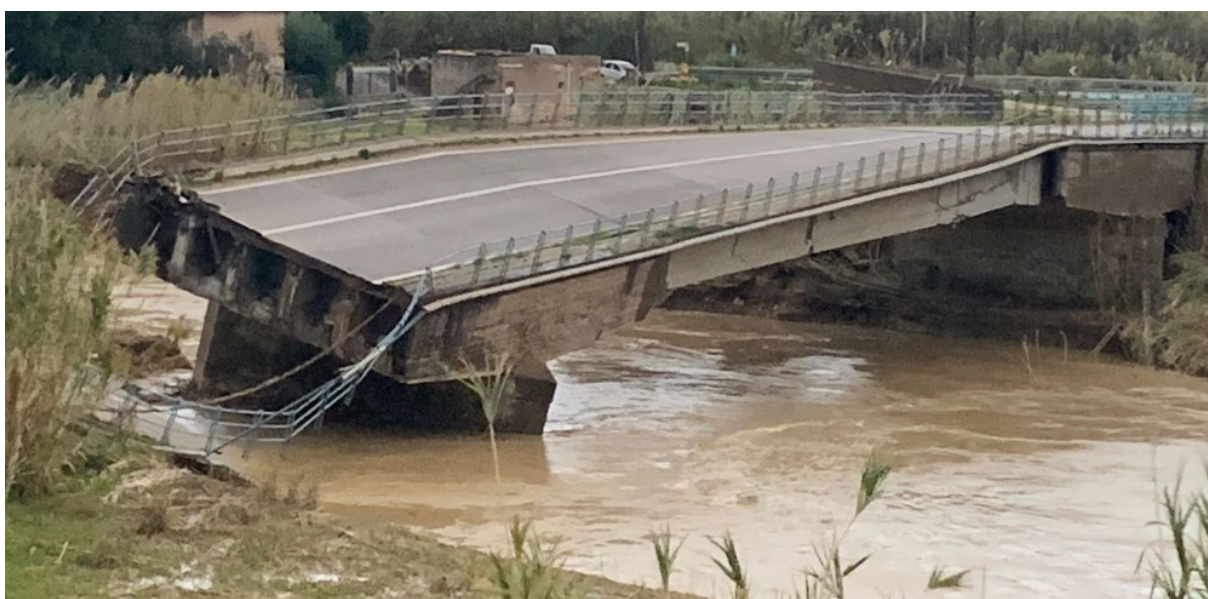
Figura 2.1.4: Esempio di crollo dell'impalcato. (Riportata in: https://www.alpauno.com/ponte-crollato-alloperagenio-militare-micro-cariche-per-demolirlo/ ).
