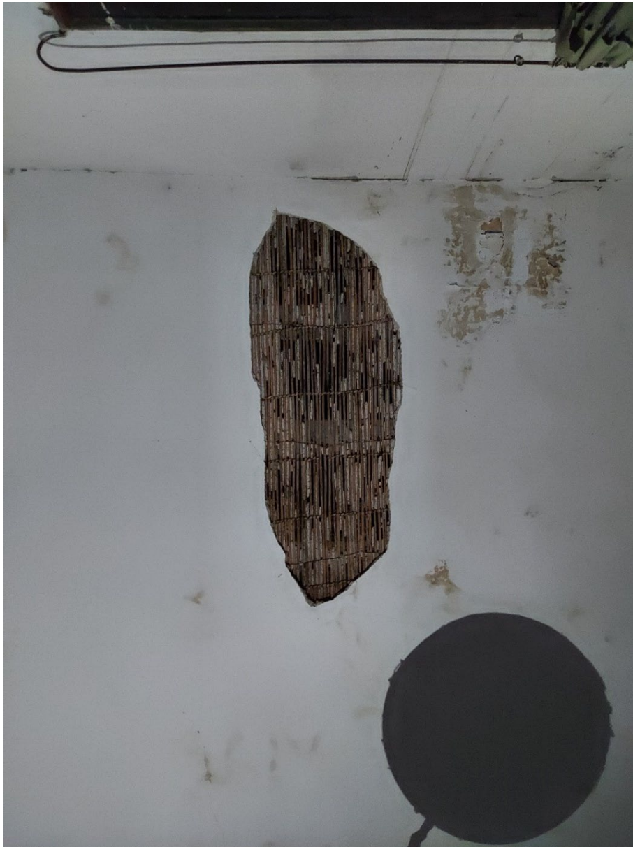
Fig.5.46 Dettaglio del solaio della sala 8 (S4). Si nota come il distacco dell'intonaco abbia portato alla luce le canne lacustri che formano la controsoffittatura 39 .
