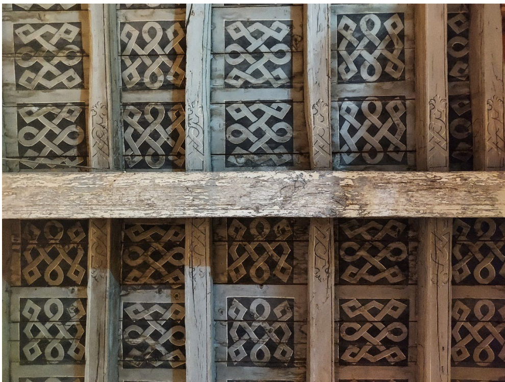
Fig.5.43 Dettaglio del solaio della sala 11 (S3). Si notano i travetti e le tavole dipinti con motivi geometrici.
