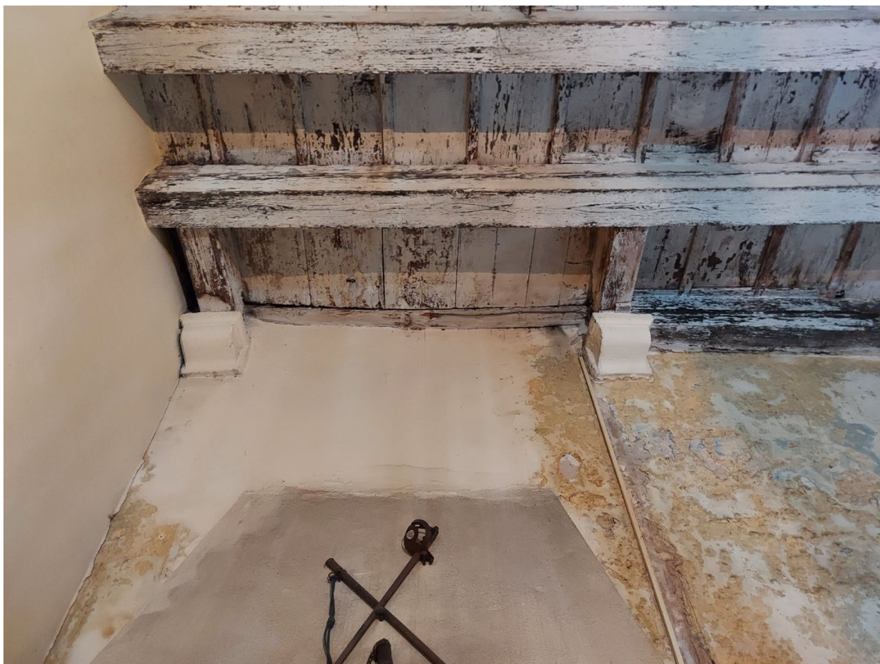
Fig.5.40 Dettaglio del solaio della sala 5b (S2). Si nota come in questo caso l'appoggio della trave non avvenga direttamente sul muro ma su una mensola in pietra. Essendo le pareti tutte intonacate risulta difficile intuire come avvenga l'appoggio per tutte le altre travi. In questo caso però l'inserimento di una mensola a sorreggere la trave rende sicuramente il solaio più stabile, permettendo una maggiore conservazione della testa della stessa 37 .
