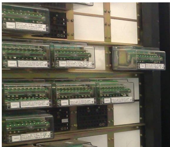
FIGURA 28 RELÈ FS58 UTILIZZATI NELL'IMPIANTISTICA RFI
