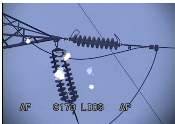
Figura 2.1.10: Scariche localizzate lungo le catene di isolatori in amarro e sul collo morto
