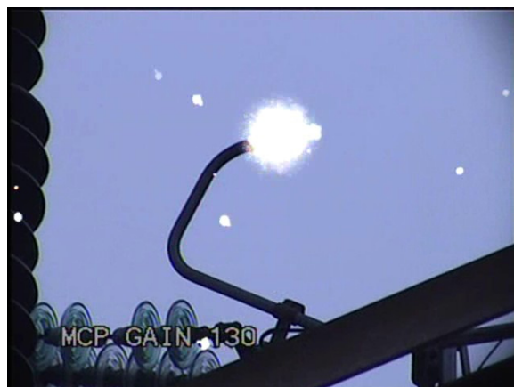
Figura 2.1.11: Presenza di sporgenze appuntite dovute a difetti costruttivi
