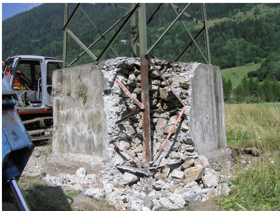
Figura 2.1.2: Esempio rottura calcestruzzo
