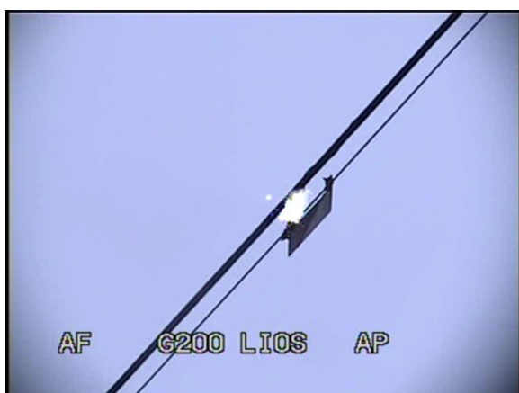
Figura 2.1.8: Trefolo rotto sul conduttore di energia sul distanziatore
