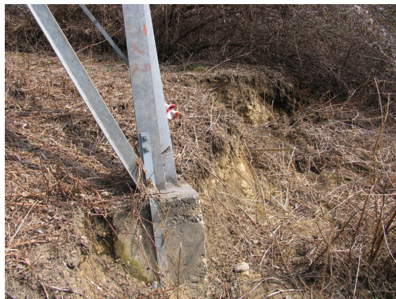
Figura 2.1.3: Esempio cedimento terreno
