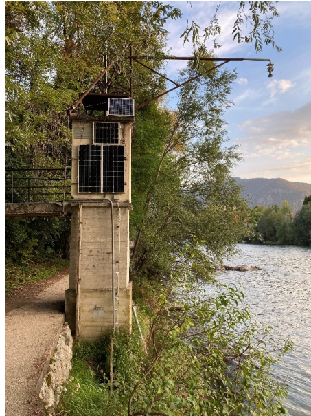
Figura 15: storica stazione di misura di Barzizza, in destra idrografica, situata di fronte all'omonima centrale idroelettrica. La misura di livello viene eseguita con un teleidrometro ad ultrasuoni. In passato, le misure di livello erano effettuate con un idrometrografo a galleggiante con registratore a penna e un'asta idrometrica.
