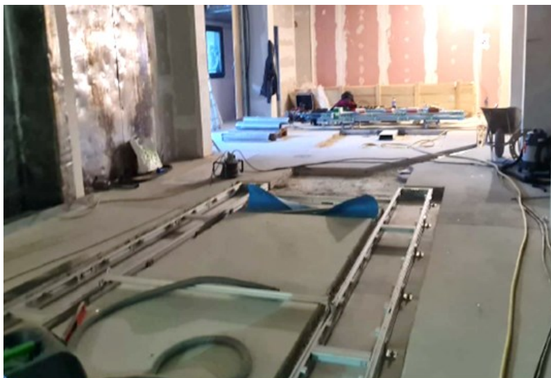
Figura 3.9: rotaia su cui scorre la TAC [31].
