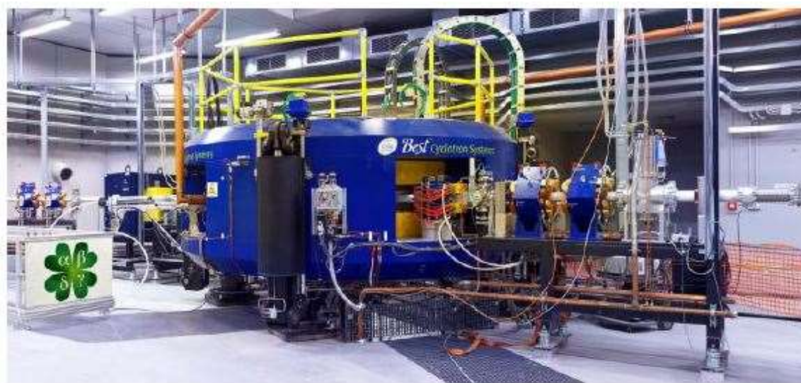
Figura 02: Foto del ciclotrone BEST 70p installato all'interno dell'edificio SPES
