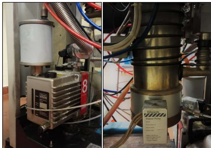
Figura 3.6: A sinistra si ha una foto della pompa rotativa e a destra una foto della pompa diffusiva, entrambe installate nell'apparato sperimentale presente nel laboratorio di Alte Temperature
