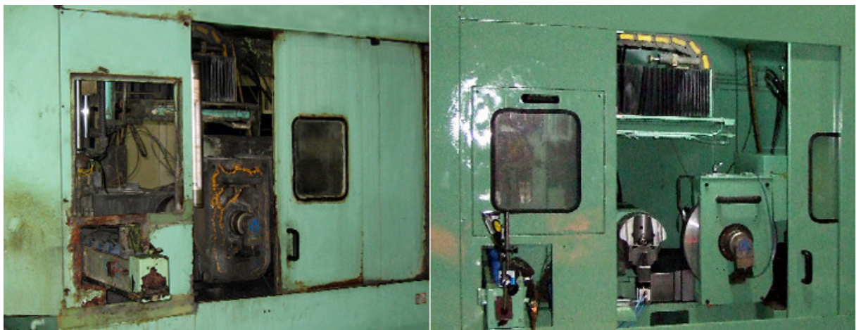
Figura 21 - Esempio di puro restyling: i componenti sono stati puliti, sostituiti o aggiustati ma non è stata aggiunta alcuna funzione (nemmeno di sicurezza) (tratta dal web)
