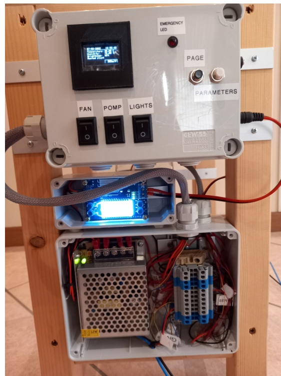
(c) Quadro elettrico completo.
