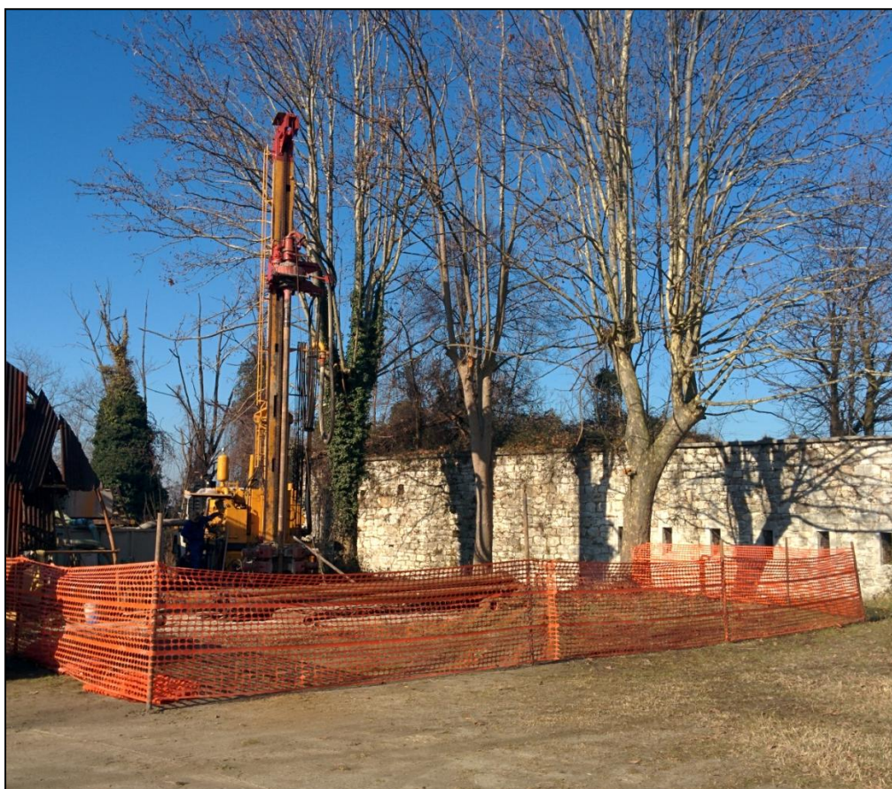
Figura 4.3 – Impianto di perforazione a rotazione automontato, con circolazione diretta dei fanghi; in basso, oltre la rete, sono visibili le aste di perforazione utilizzate, ciascuna dalla lunghezza di 6 m e diametro di 140 mm.
