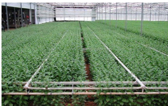
Figura 60 Impianto a tubi radianti.
