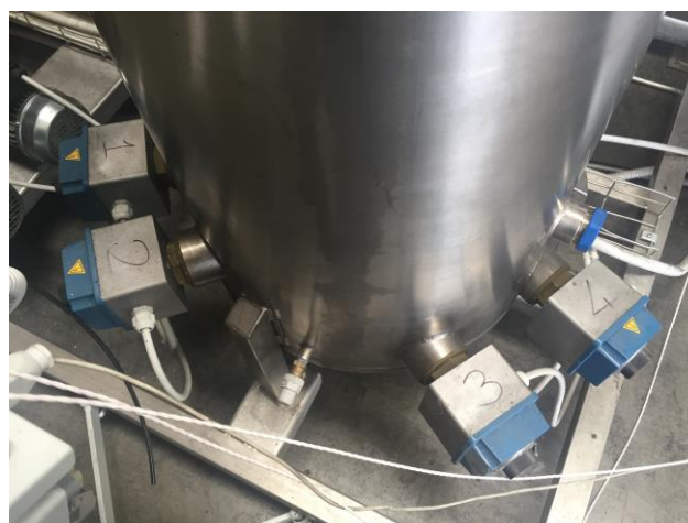
Figura 16. Resistenze da 5kW l'una per la simulazione del cascame termico
