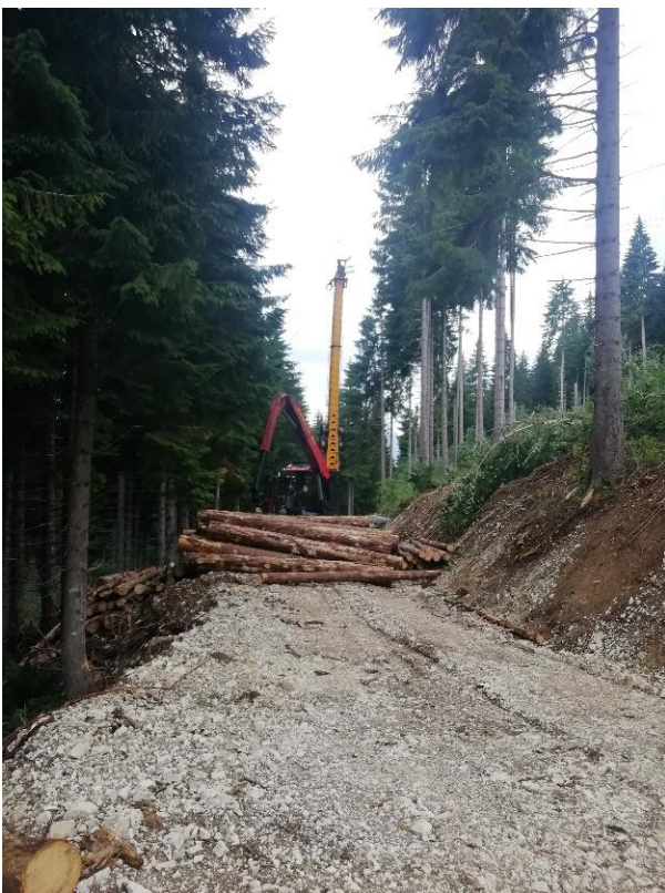
Figura 2.1.1.10: gru a cavo presente nel lotto Conca di Enego. Esempio di imposto di limitate dimensioni
