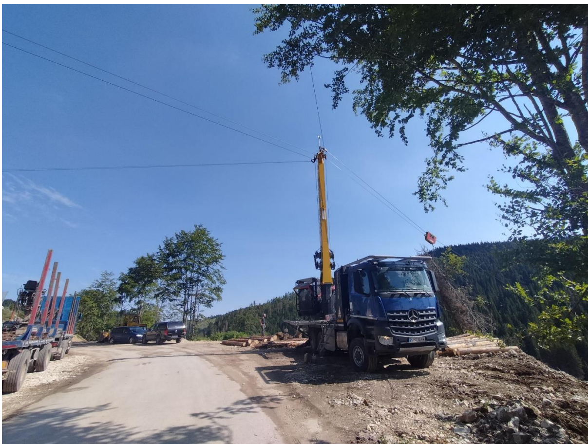
Figura 2.11.2: gru a cavo con gli ancoraggi passanti sopra la strada principale asfaltata: in questo caso la strada non è stata chiusa al traffico nonostante l'evidente situazione di pericolo.
