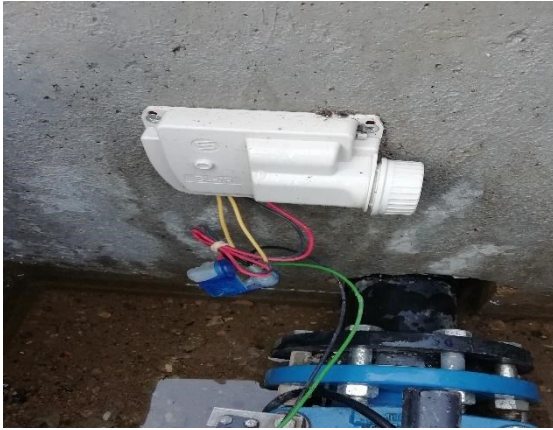
Figura 31 Centralina bluetooth collegata alla pompa del pozzetto 1
