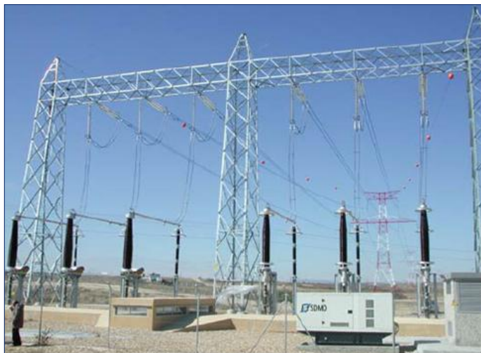
Figura 3.4 - sottostazione di transizione linea aerea / cavo
