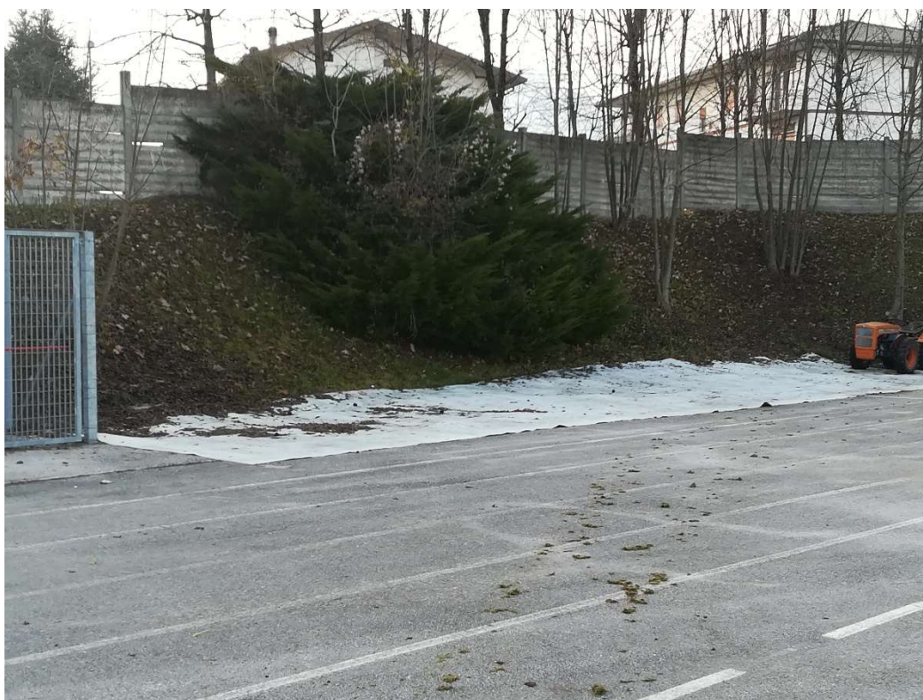
Figura 5.10. Zona di ubicazione della torre faro D e del relativo quadro elettrico (QTFD)
