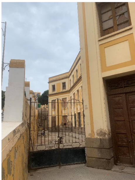
Figura 28 Si può osservare il buco in una delle finestre tappate in seguito allo sgombero
