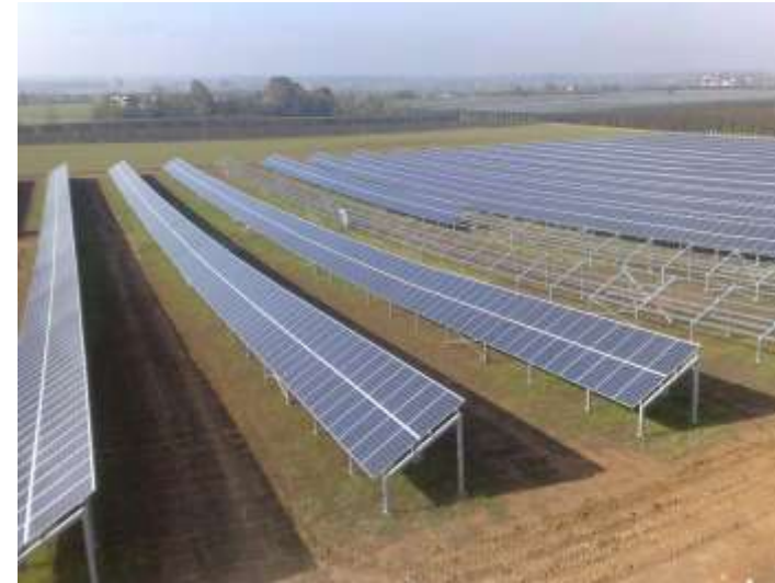
3. Impianto fotovoltaico a terra
