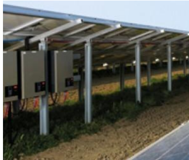
Figura 6.3 Impianto con inverter di stringa
