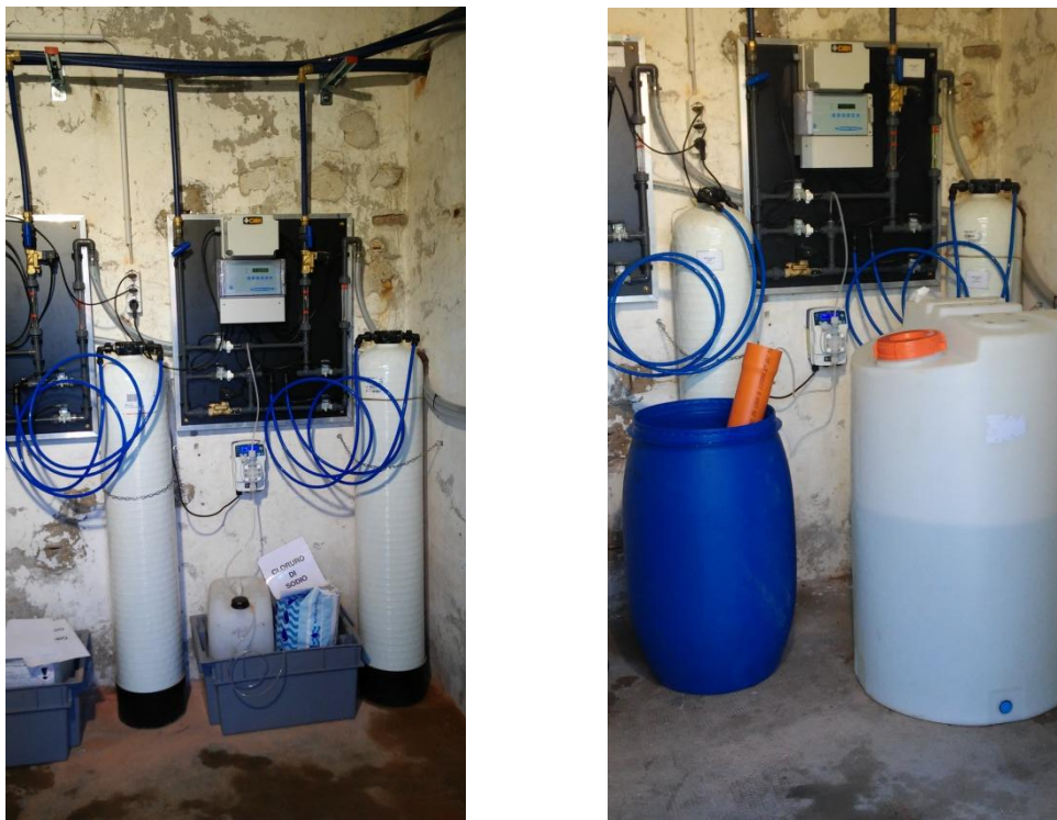
Figura 3.3: Impianti pilota installati da Acque del Chiampo per la sperimentazione di resine a scambio ionico.
