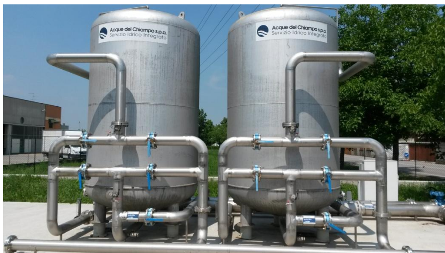
Figura 2.2: Impianto di filtrazione a Carboni Attivi Granulari di Lonigo.
