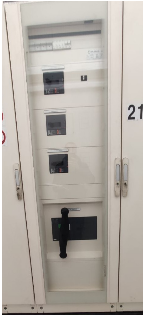
Figura 3.5: Quadro Interno dell'Azienda
