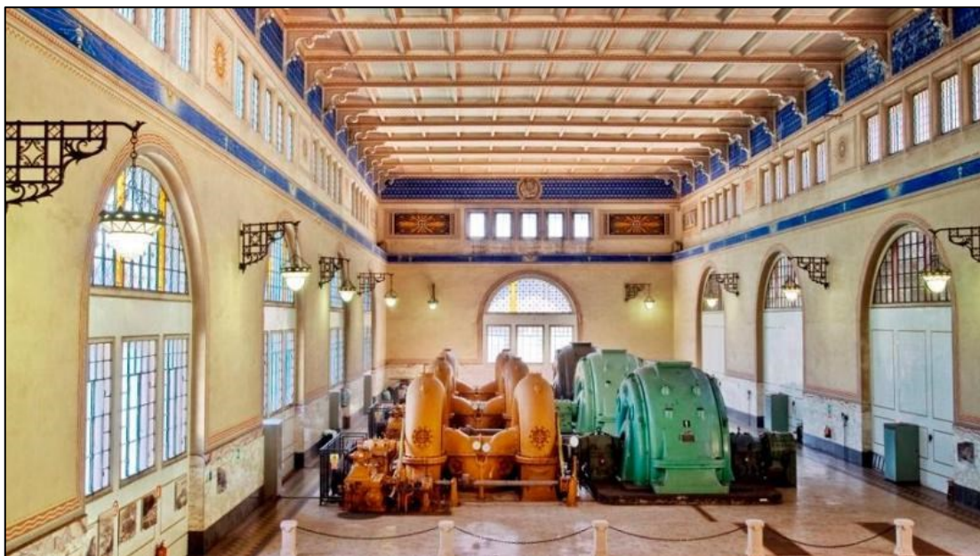
Figura 4.5: La centrale idroelettrica di Nove (1925); vista interna sala macchine. Fonte: https://progettodighe.it/centrali/
