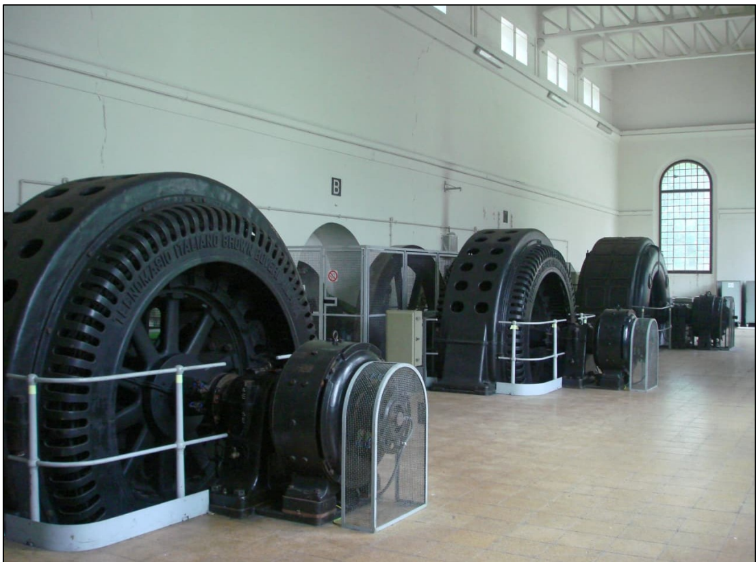
Figura 5.13: Vista interna, “sala macchine”, centrale di San Floriano (1919).
