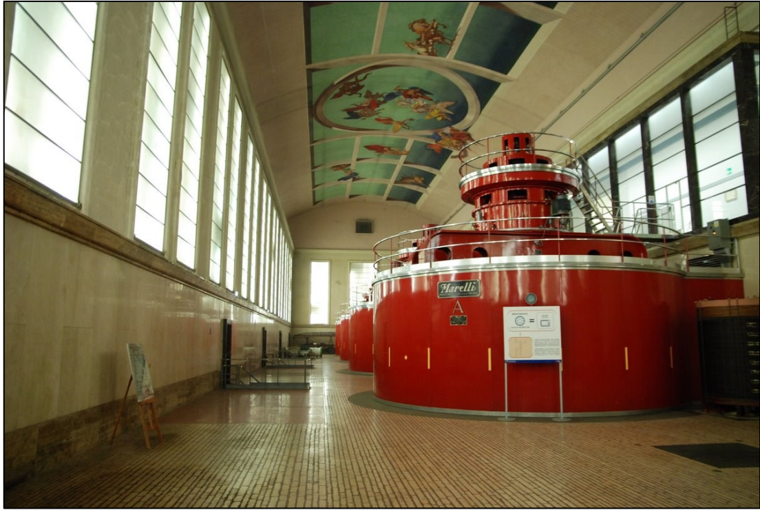
Figura 2.8: Centrale in caverna "Achille Gaggia" a Soverzene (BL); vista interna, sala macchine. Fonte: https://progettodighe.it/centrali/achille-gaggia-soverzene-bl/
