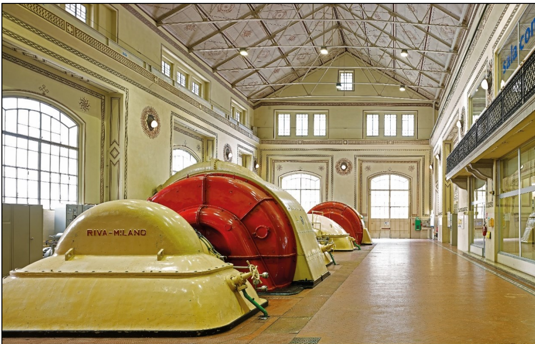
Figura 2.11: Centrale di Cogolo (1929); vista interna.
