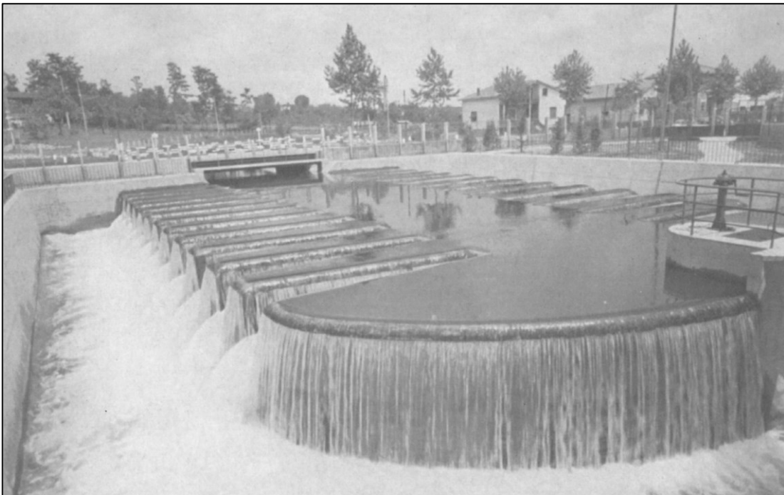
Figura 4.1: Sfioratore all'imbocco del sifone terminale in località Colfosco (TV).
