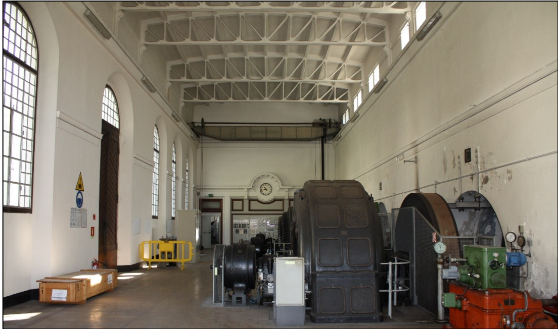
Figura 5.14: Vista interna, “sala macchine”, centrale di San Floriano (1919).
