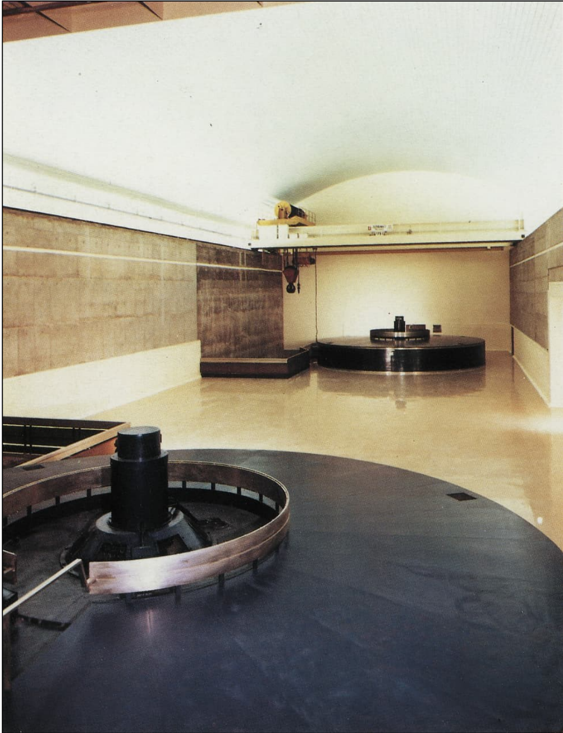
Figura 4.14: La centrale idroelettrica di Fadalto (1972); vista interna, sala macchine. Fonte: https://progettodighe.it/centrali/
