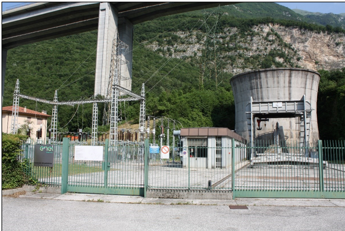
Figura 4.10: La centrale idroelettrica di San Floriano Nuova (1961); vista esterna. Fonte: https://progettodighe.it/centrali/
