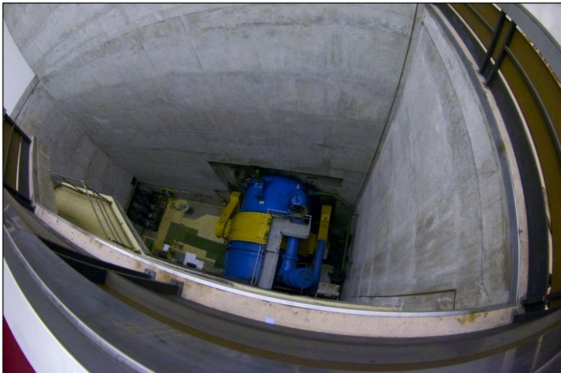
Figura 4.11: La centrale idroelettrica di Nove Nuova (1971); vista turbina. Fonte: https://progettodighe.it/centrali/
